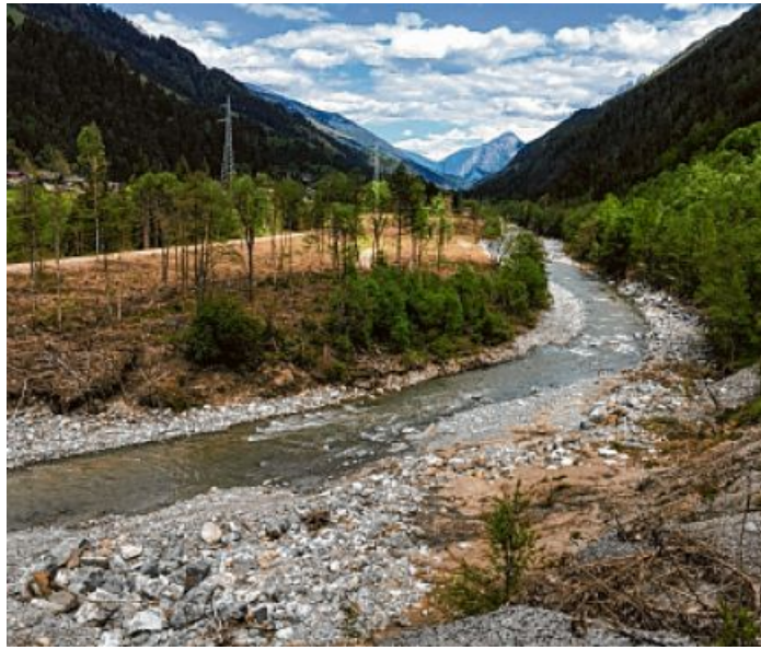
Unterhalb der Rieder Brücke entsteht eine Retentionsfläche. Der Radweg führt nun links der Drau nach Thal.
